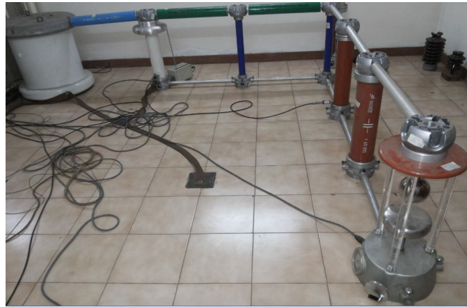
Figura 5: circuito montado para geração e medição de altas tensões contínuas. Fonte: (Autor)
